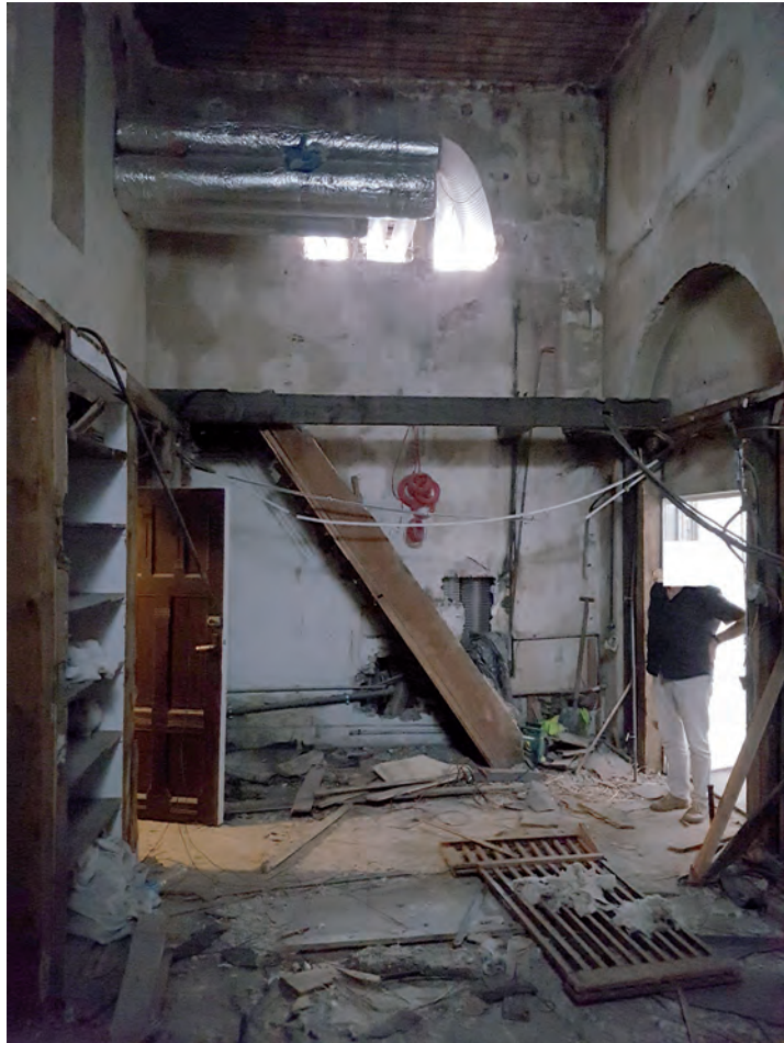
Ryc. 5. Przebudowa istniejącego budynku zgodnie z procedurą „za-projektuj i wybuduj” wykonana tylko na podstawie rysunków płaskich CAD. Nowa wentylacja (projektowana jedynie na rzutach 2D liniami) miała przechodzić nad schodami. Niestety na płaskim rzucie projektanci „nie zauważyli” braku miejsca niezbędnego do korzystania ze schodów. Błąd, którego można by bez trudu uniknąć, gdyby przygotowano dokumentację trójwymiarową (fot. P. Wojsznis)
