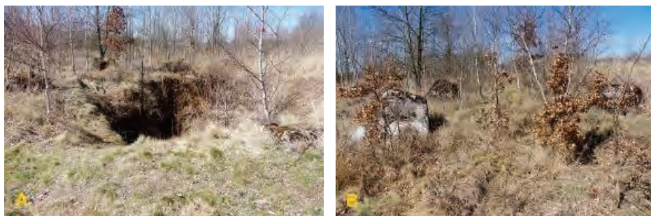
Ryc. 7. Szyb (złożo „Majewo”): A – zapadlisko szybu, B – betonowe podpory wieży szybowej i pozostałości hałdy (stan z 7.04.2011 r., fot. D. Wójcik)
