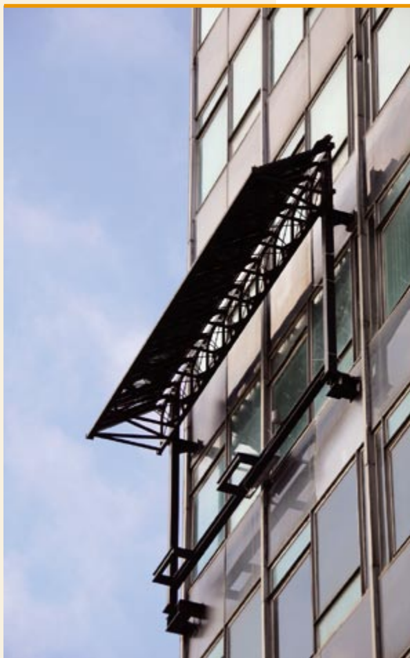
Fotowoltaiczne nadwieszenie zaciemniające na budynku C-7
