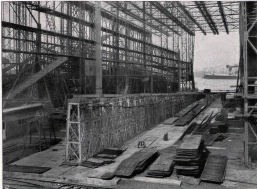
Abbildung 63. Kielstapelung des Riesendampfers „Imperator“ der Hamburg-Amerika-Linie (Vulcanwerke in Hamburg). (Hauptabmessungen s. Abbildung 26.) Infolge der zum Stapellauf nötigen geneigten Lage des Kiels sind am Vorderende sehr hohe Stapel erforderlich.
