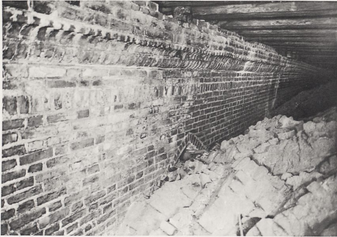
21a. Gesims und Fenster an der Außenwand der Basilika über dem südlichen Seitenschiff
