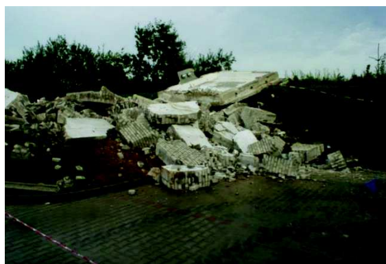
Rys. 6.13 Budynek stacji transformatorowo-rozdzielczej po jego zawaleniu się (Protokół Kontroli 08062-5303-K031-Pt/11)
