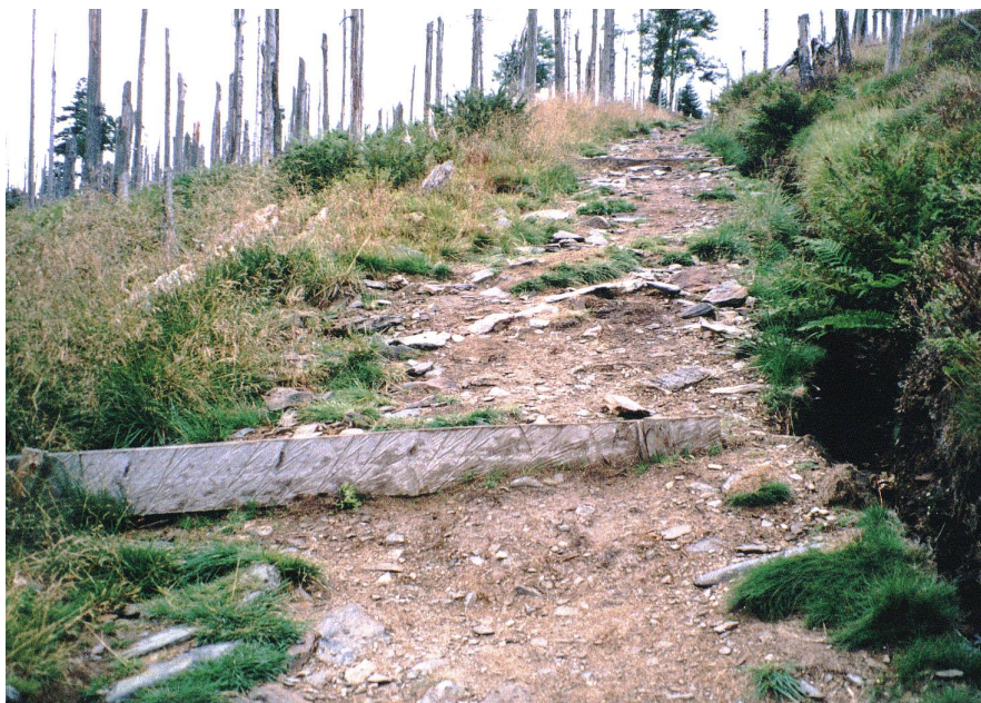
Ryc. 48. Zniszczenie naturalnej nawierzchni szlaku czarnego na Sowią Przełęcz, pomimo istnienia urządzeń przeciwozyjnych wychwytyjących i odprowadzających wodę oraz zatrzymujących materiał (odcinek S3).
