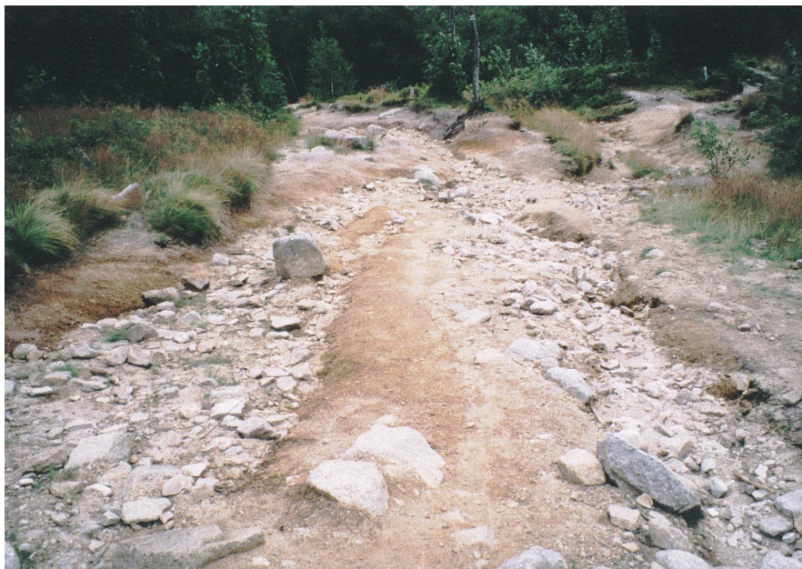
Ryc. 41. Powierzchnie degradacyjne na Drodze Bronka Czecha (odcinek B4).
