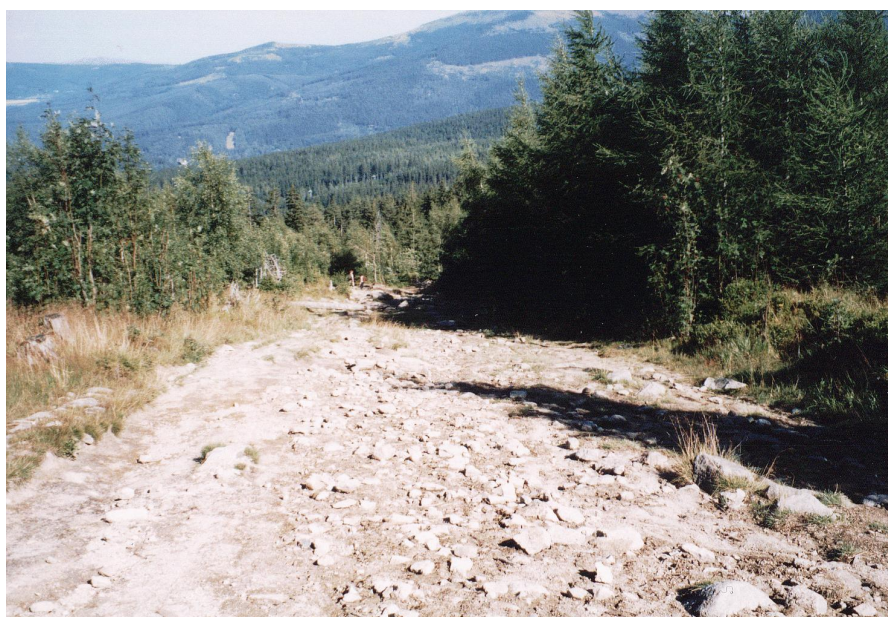
Ryc. 77. Nadmiernie szeroki i rozdeptany odcinek, niezabezpieczony barierkami (B4).
