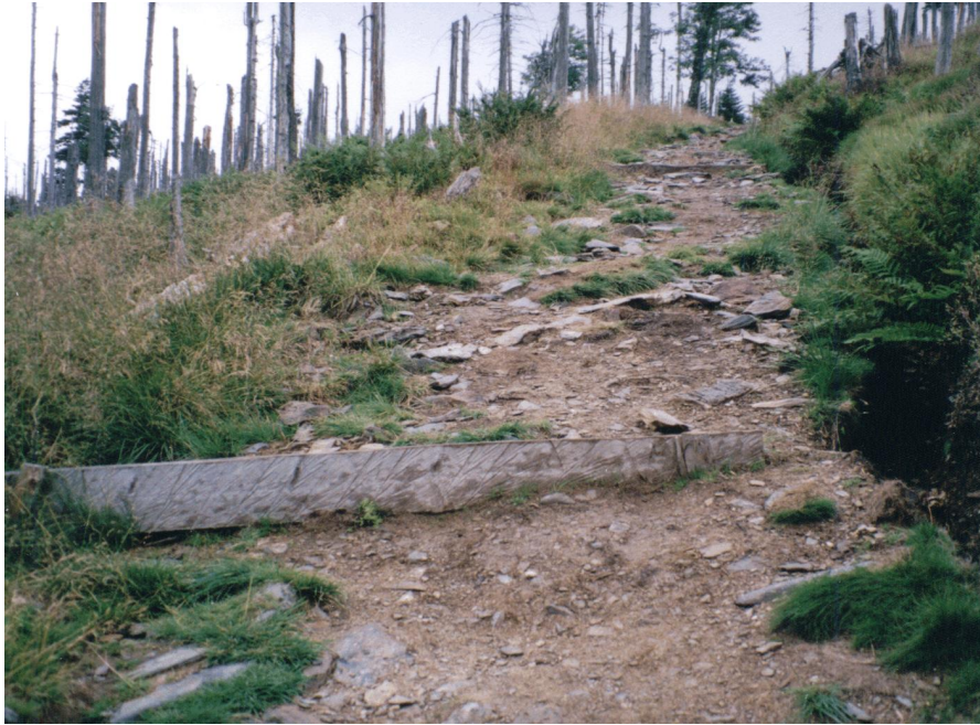
Ryc. 78. Odcinek S3 wymagający poprawienia i zagęszczenia zabudowy przeciwozyjnej.
