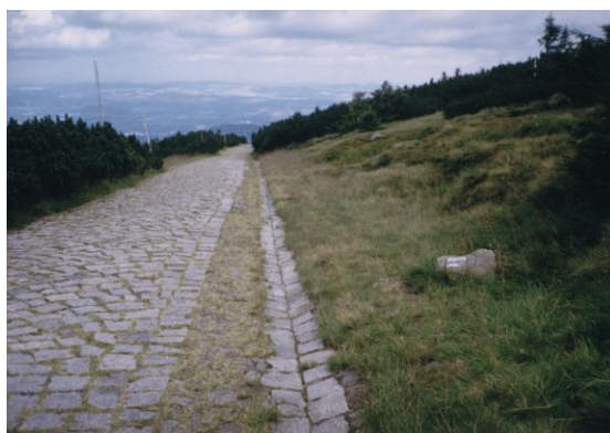
C) Rów odwadniający wyłożony kostką granitową.
