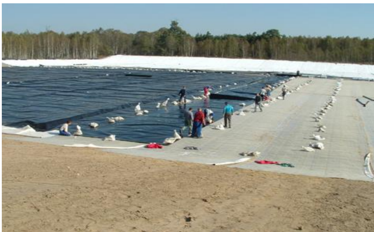
Rys. 30. Zdjęcie z budowy wykonania okrycia dna kwatery matą bentonitową, folią PEHD oraz geowłókniną [ MSO]
