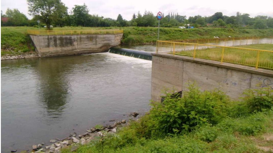
Fot. 7. Betonowe umocnienie brzegu rzeki przy progu wodnym Pic. 7. Concrete strengthening the river bank at the threshold of water Źródło: Praca własna / Source: Own work
