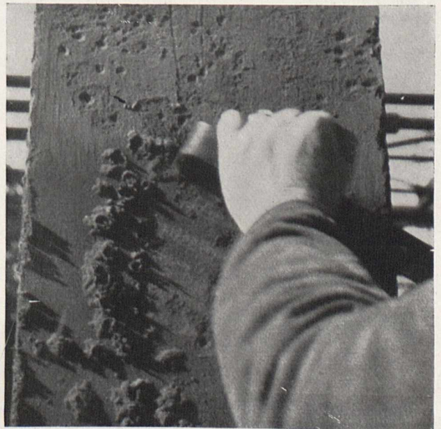
Bild 5. Typische Rostbildung an einer Eisenkonstruktion in einer chemischen Fabrik. Flächenrost in sehr schön ausgebildeten Rostrosen, die nach der Entfernung mit dem Kratz Eisen tiefe Löcher freigeben.
