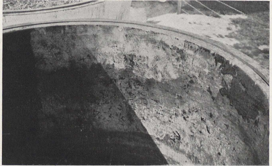
Bild 3 (oben). Entleerter Grünfuttersilo nach \frac{3}{4} jähriger Beanspruchung bei Verwendung eines ungeeigneten Anstrichs. Nur die geringen dunklen Stellen zeigen die Reste des Anstrichs an.
