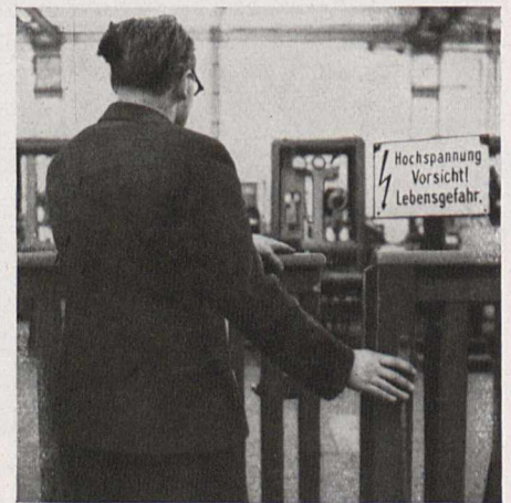
Fig. 6. Der Hochspannungsraum ist von der übrigen Prüfhalle durch ein Gitter getrennt
