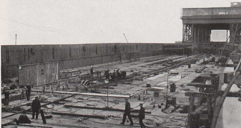
Fig. 2. Diese Stahlbrücke wird mit Wasser gefüllt. Sie schließt sich an das Hebwerk direkt an, mit dem sie durch ein Schleusentor verbunden ist. Wenn die Schiffe aus dem niedrigen Kanalniveau gehoben worden sind, gleiten sie über die Brücke in den oberen Kanal.
