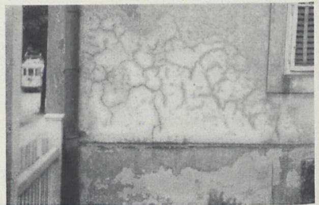
Fig. 2. Risse im Verputz als Bahnen der zur Oberfläche vordringenden Mauerfeuchtigkeit. Die Umgebung der Risse ist verfärbt. Man beachte den Unterschied zu Fig. 1.
