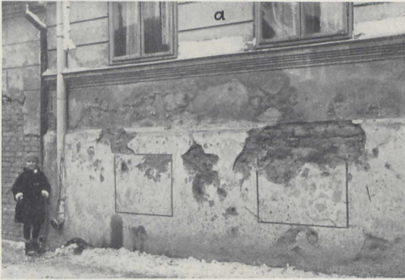
Fig. 6. Abfallen großer Platten eines dicken, dichten Verputzes von der Hausmauer (links wo das Kind steht) sowie im oberen Teil des Sockels am Gebäude rechts.
