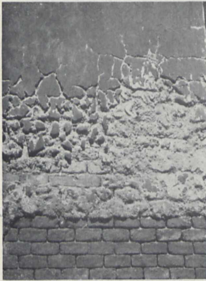
Fig. 1. Alte Mauerfläche (Westwand), welche nach Schwindrissen lediglich durch direkte atmosphärische Einwirkung von außen nach innen fortschreitend abwittert
