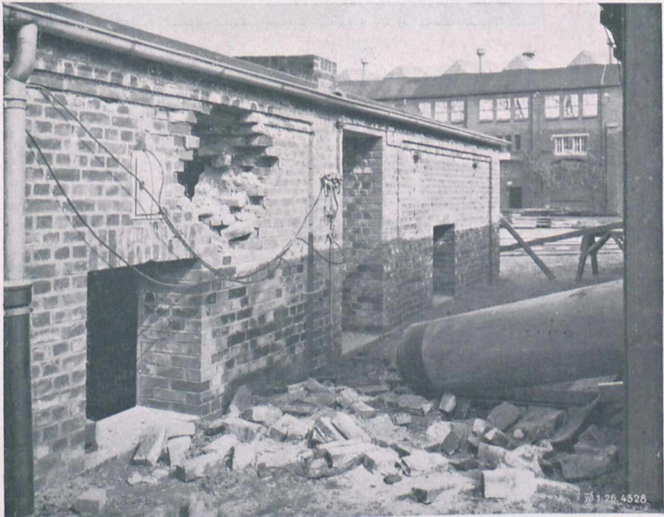
Rückschlagsloch des Sauerstoffbehälters, der noch in die Wand des gegenüberliegenden Hauses drang.
