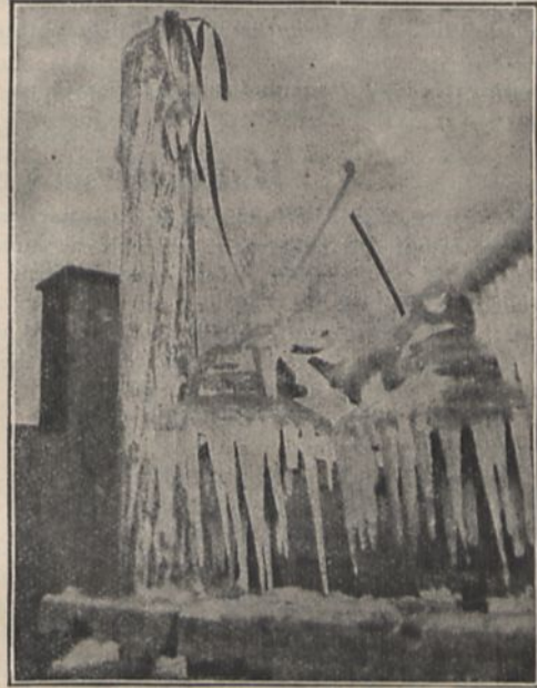
Ansicht von vereisten Mastschaltern.
