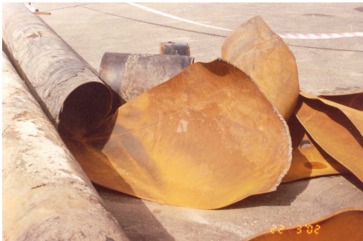
Rys. 3.5. Fragmenty rur gazociągu po eksplozji – zerwanie obwodowe
