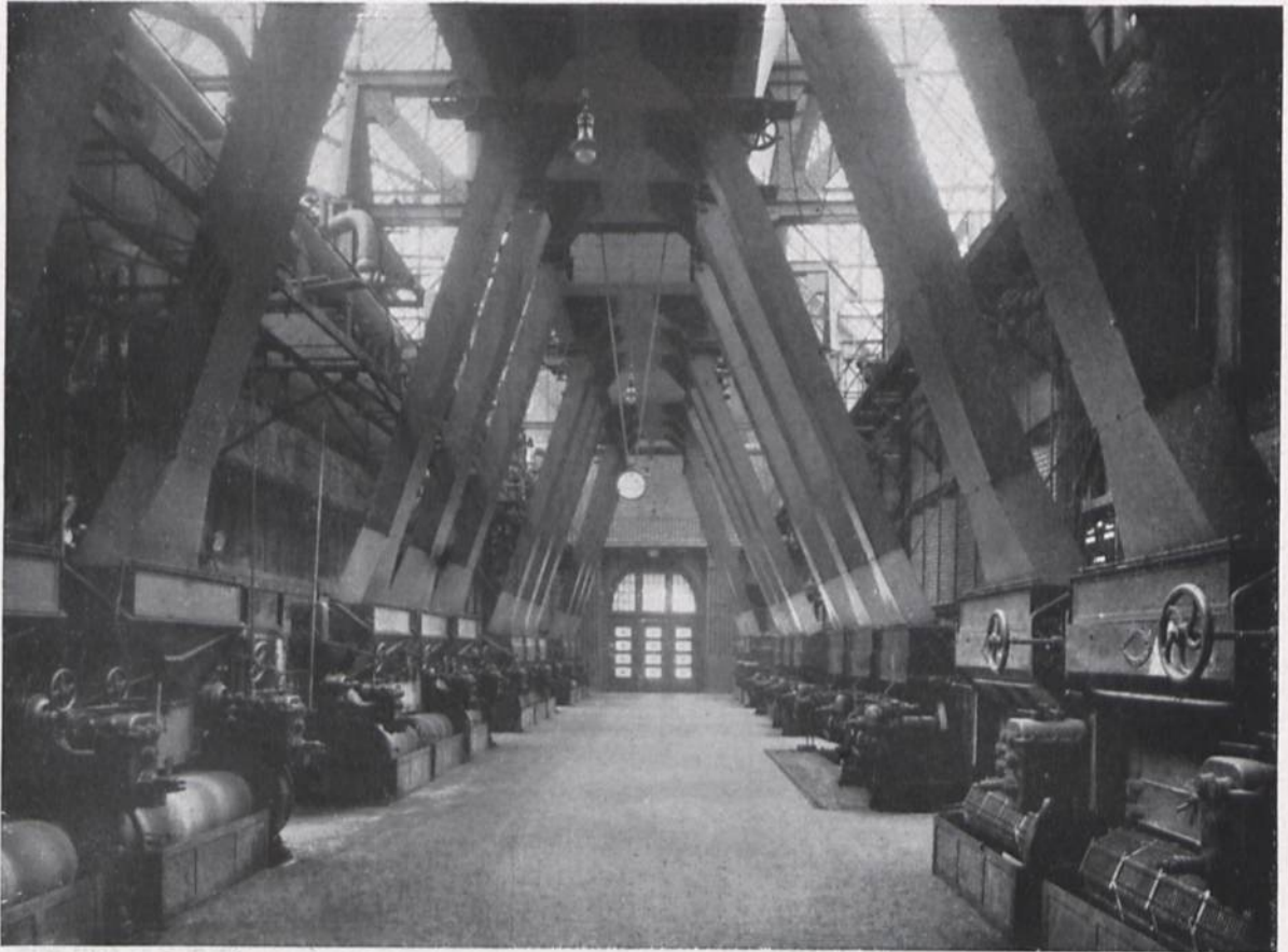
Elektrizitätswerk Zaborze, „Moderne Kesselanlage
