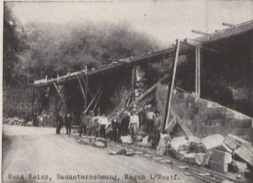
Die baufällige Eisenbahnüberführung vor Witten wurde nebst den anschließenden Stützmauern unter voller Aufrechterhaltung des Bahn- und Straßenbetriebes erneuert.
