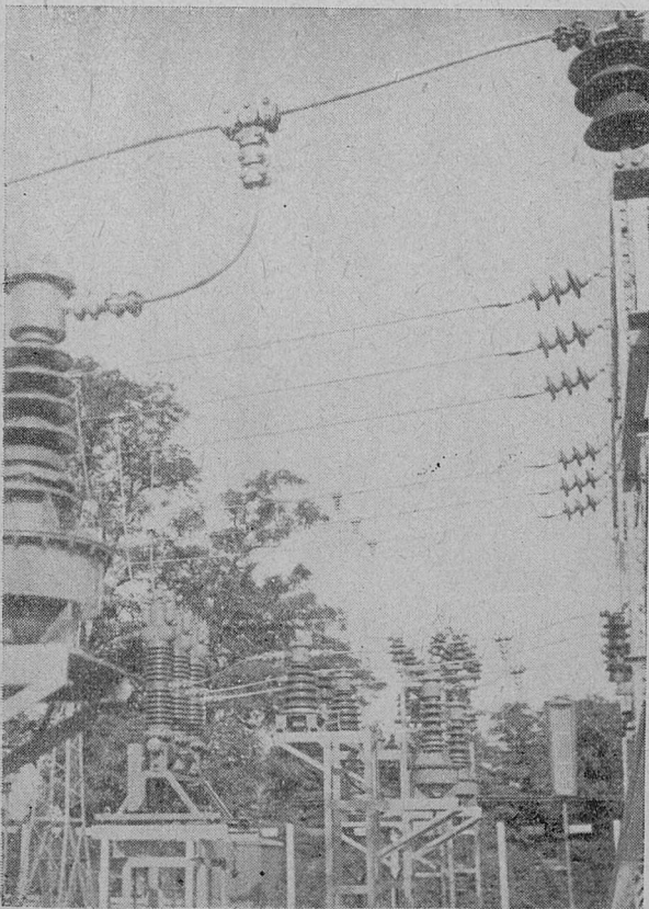
Rys. 11. Fragment stacji po stronie 30 kV
