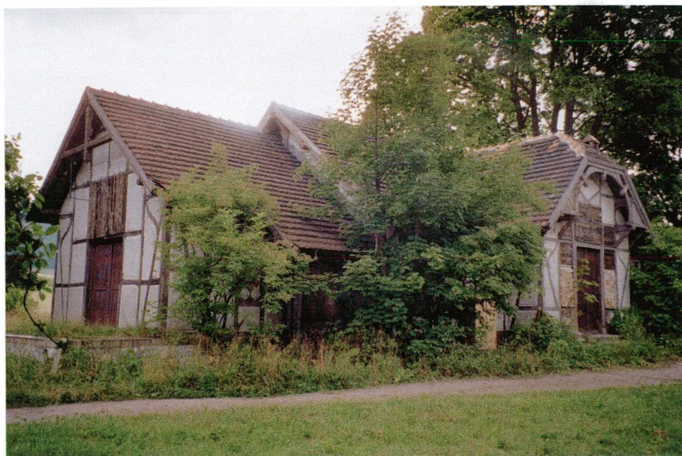
Fot. 11 Żelazno. Porzucony dworzec znajduje się w złym stanie technicznym, ale ciągle jeszcze widać interesującą sznycerkę tego proporcjonalnego budynku. Widok od strony podjazdu.
