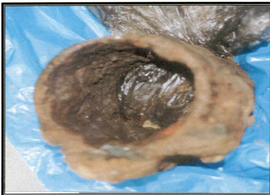
FOTOGRAFIA 5.2. Osad na wewnętrznej powierzchni rurociągu stalowego (punkt 3)
