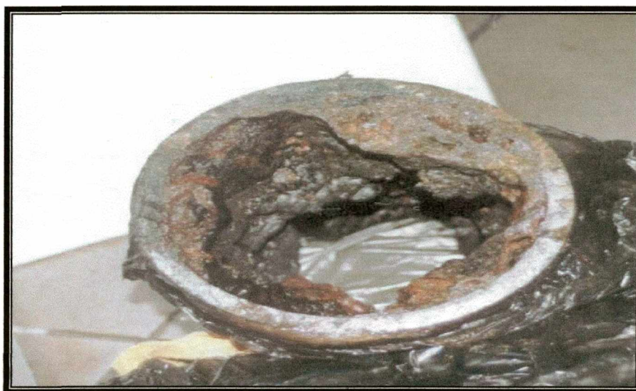
FOTOGRAFIA 5.1. Osady na wewnętrznej powierzchni rurociągu żeliwnego (punkt 8)
