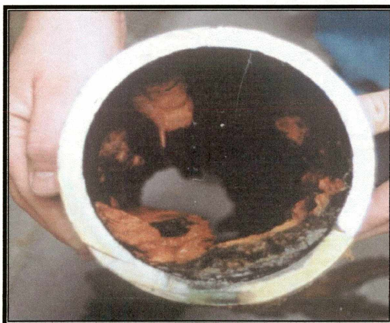
FOTOGRAFIA 5.3. Osady zdeponowane na wewnętrznej powierzchni przewodu rozdzielczego (punkt 5)
