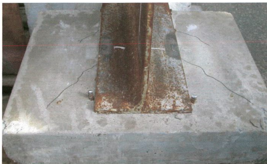
Rys. 5.15. Zniszczona próbka ścinana – rysy ukośne w płycie betonowej (próbka Z1)
