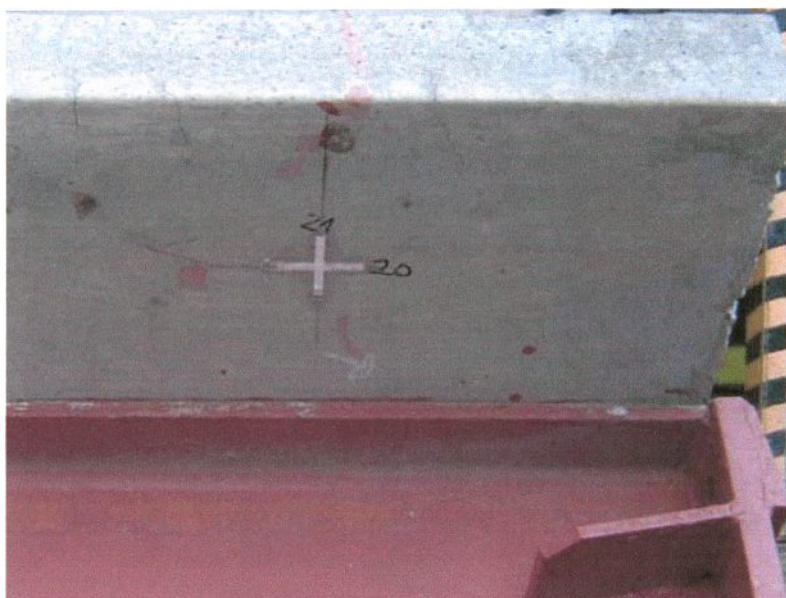
Rys. 6.37. Rysy ukośna w strefie podparcia
