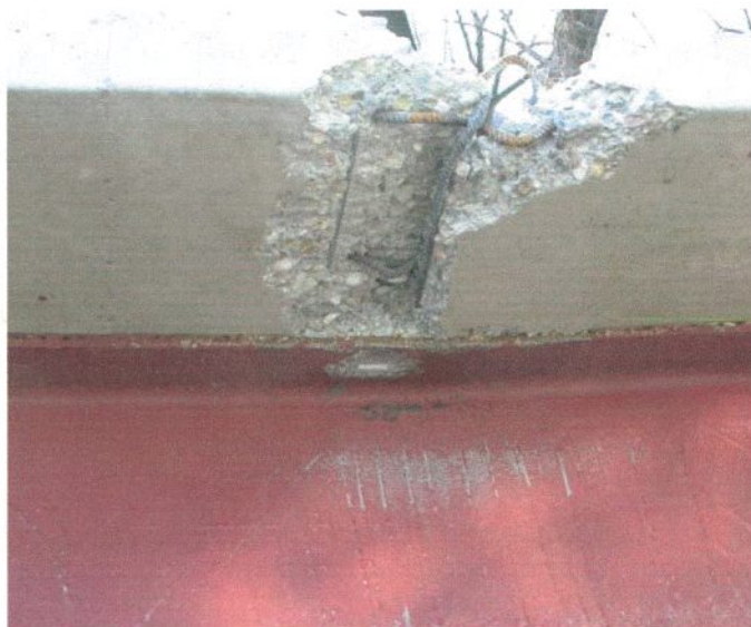
Rys. 6.52. Płyta po zniszczeniu – widok od spodu
