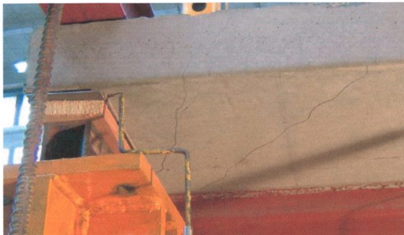
Rys. 6.32. Rysy ukośne w strefie podparcia
