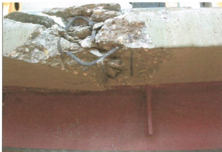
Rys. 6.58. Mechanizm zniszczenia – widok z lewej strony belki
