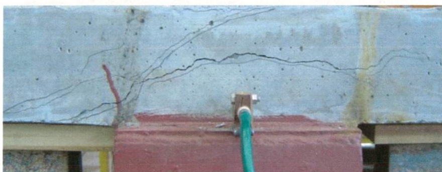
Rys. 6.29. Rysa nad zespoleniem na końcu belki po zniszczeniu
