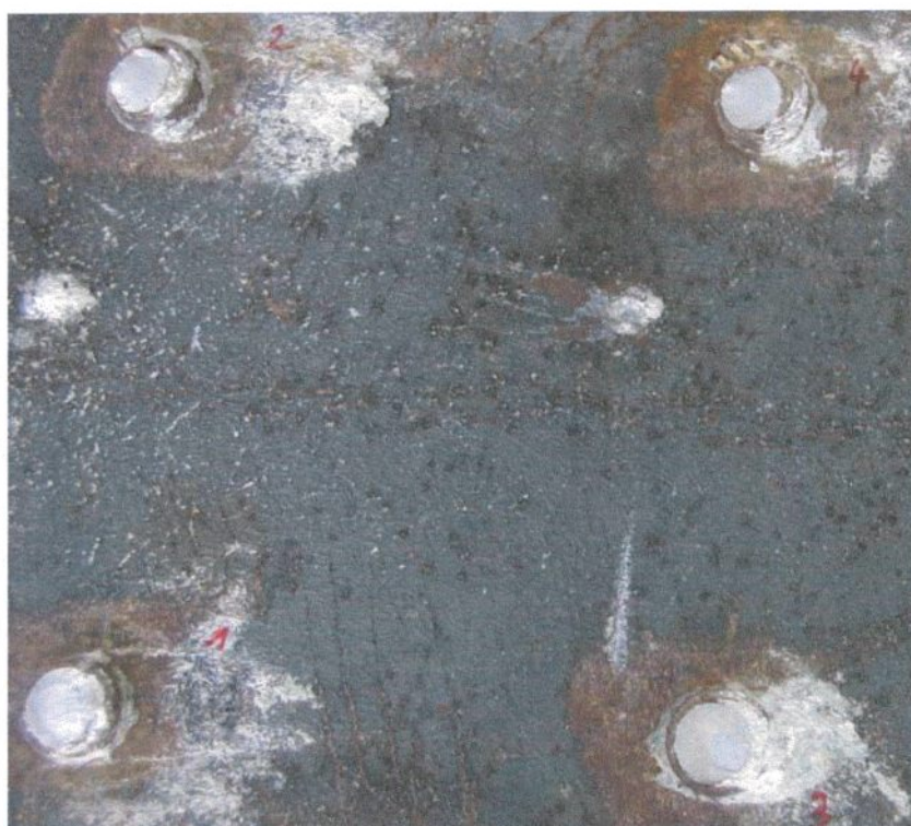
Rys. 5.14. Zniszczona próbka ścinana – łączniki ścięte (próbka Z1)
