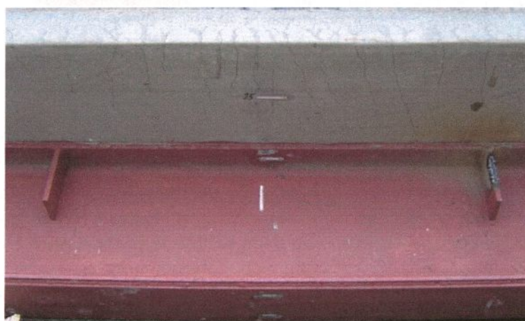
Rys. 6.35. Układ rys w płycie betonowej po odciążeniu
