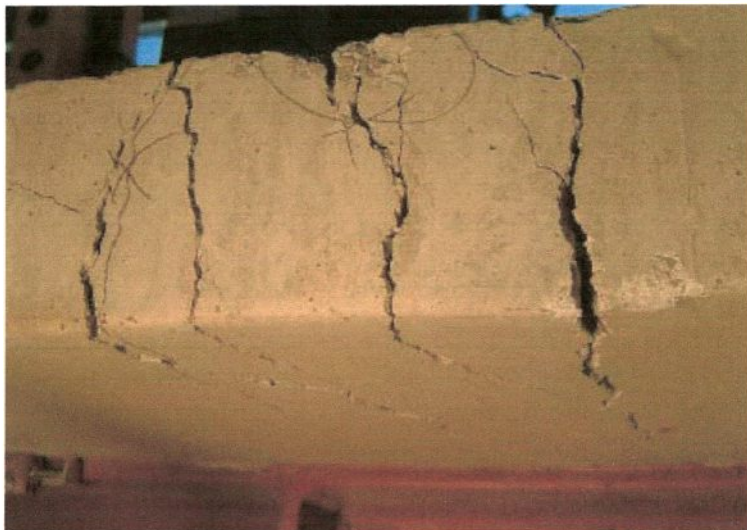
Rys. 6.45. Mechanizm zniszczenia – płyta z prawej strony belki
