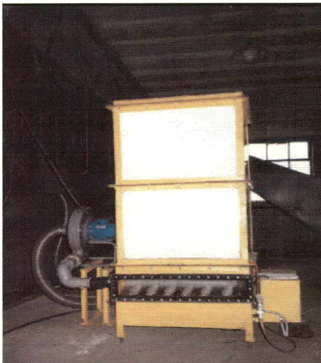
Rysunek 7.10. Biofiltr pilotowy na stanowisku pomiarowym.
