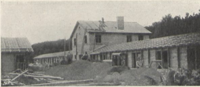
Abb. 159. Schweinezucht- und Mastanlage Osterholz bei Stendal im Bau. (Ausführung: Arthur Müller, Land- und Industriebauten G. m. b. H., Berlin.)
