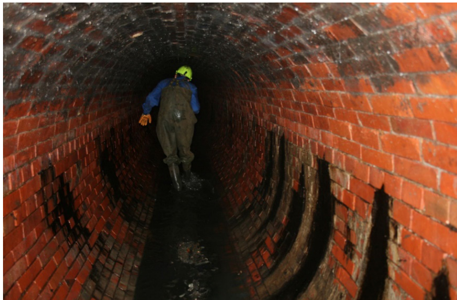
Rys. 4.2. Wnętrze przewodu – widoczne nacieki solne (fot. autorska)
