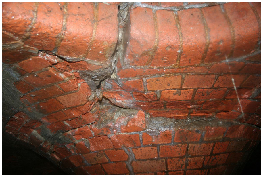
Rys. 3.37. Pęknięcie konstrukcji od strony wylotu (fot. autorska)
