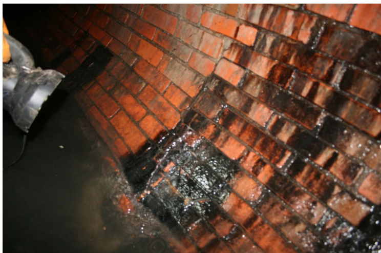
Rys. 4.6. Punktowy przeciek wody (fot. autorska)
