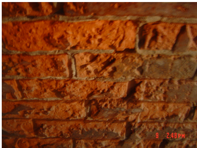
Rys. 3.1. Powierzchnia kanału murowanego po usunięciu (hydrodynamicznie) skorodowanej warstwy cegły (fot. autorska)
