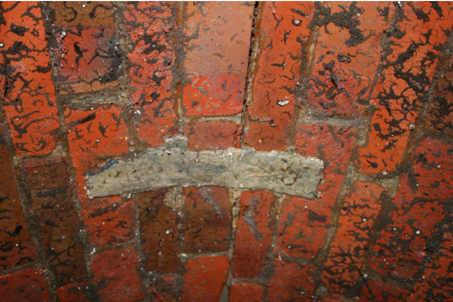
Rys. 4.4. Rysa podłużna w kluczu – brak zarysowania sondy kontrolnej, co świadczy o ustabilizowaniu szerokości rysy (fot. autorska)
