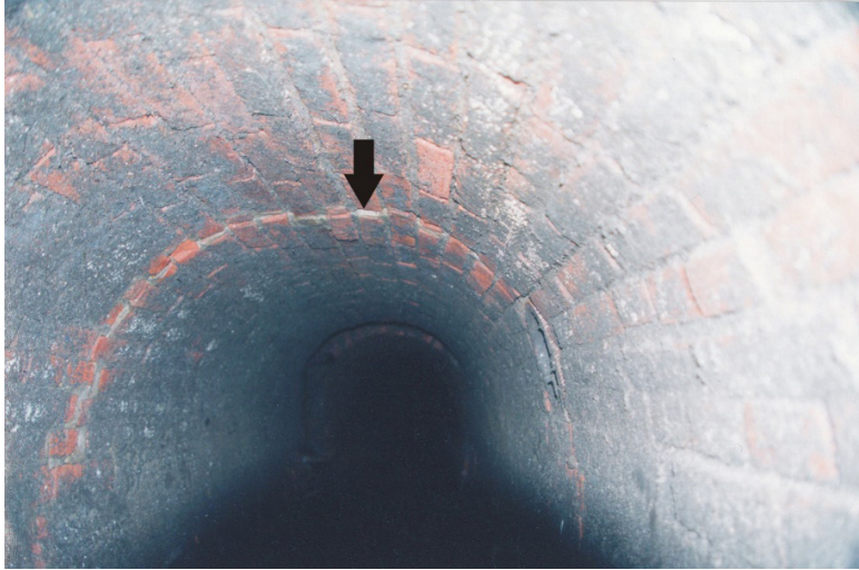
Rys. 2.3. Poprzeczne pęknięcie konstrukcji kanału ceglanego
