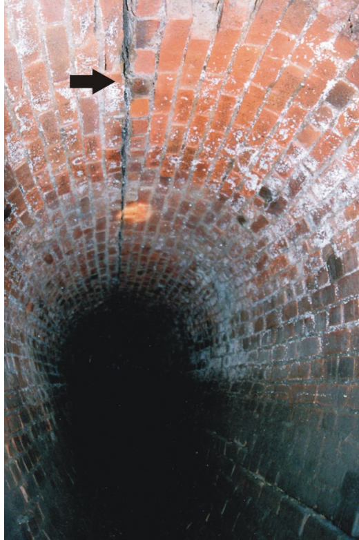
Rys. 2.1. Podłużne zarysowanie kanału w kluczu
