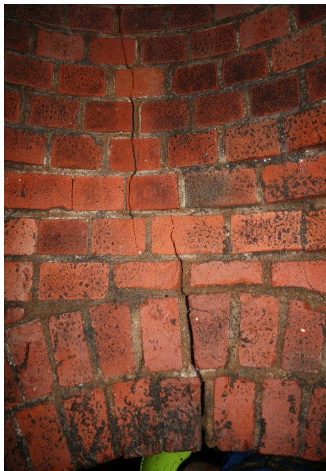
Rys. 4.5. Zarysowanie konstrukcji studni i kanału w sąsiedztwie studni (fot. autorska)
