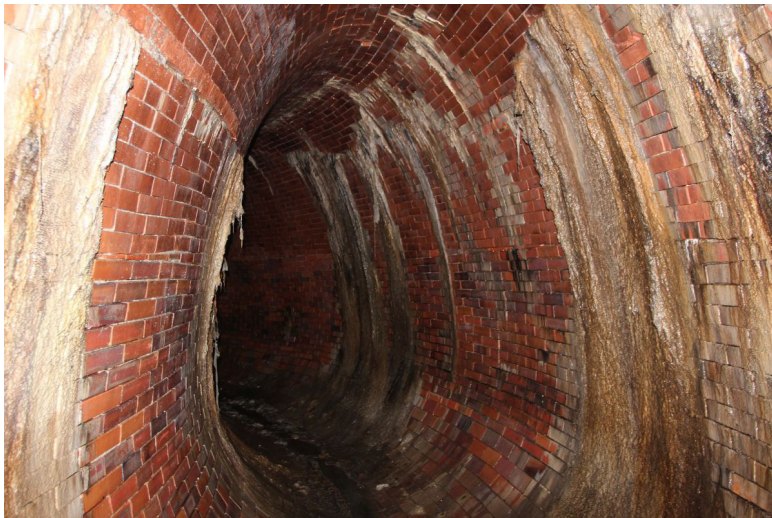
Rys. 2.4. Przecieki wody do wnętrza powodujące nacieki solne (fot. autorska)
