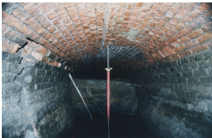
Rys. 2.5. Pęknięcie kolektora w kluczu z przemieszczeniem konstrukcji i ubytki cegieł w ścianach
