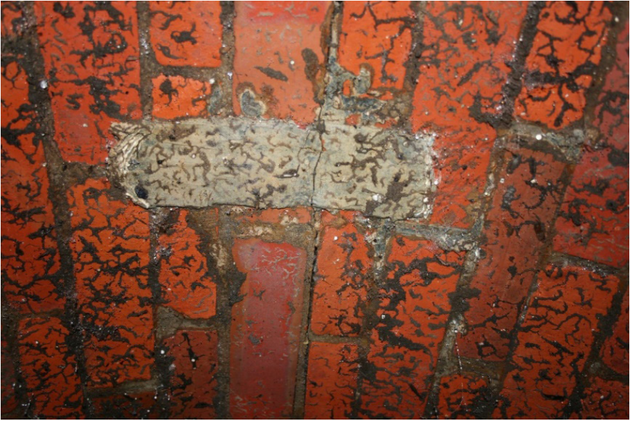
Rys. 4.3. Rysa podłużna w kluczu – widoczne zarysowanie sondy kontrolnej (fot. autorska)
