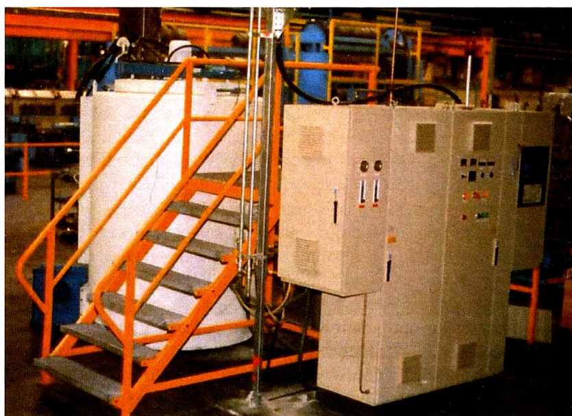
Rys. 3.15. Urządzenia sterujące procesem azotowania w technologii Nitrex
