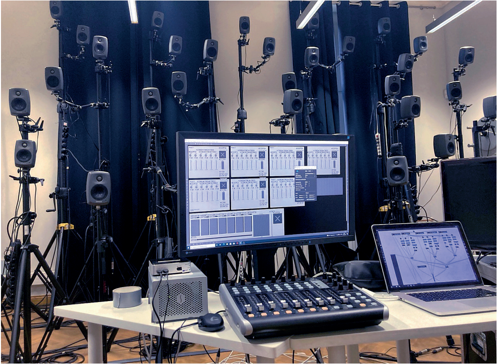
Rys. 10.5. Instalacja prototypowa Akusmonium
