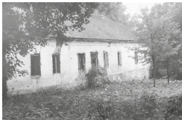
Il. 162. Widok na wschodnią (tylną) elewację dworu w Januszkowicach. Fot. Jan Olech, 1984
