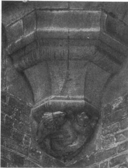
135. Kreuzkirche. Auskragung der Wendeltreppe in der WFront
